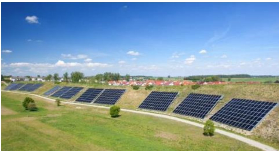
Abbildung 4-4 Freiflächen-Solarthermieanlage in Crailsheim (Quelle: www.sonnewindwaerme.de/solarthermie/solare-waermenetze-baden-wuerttemberg )
