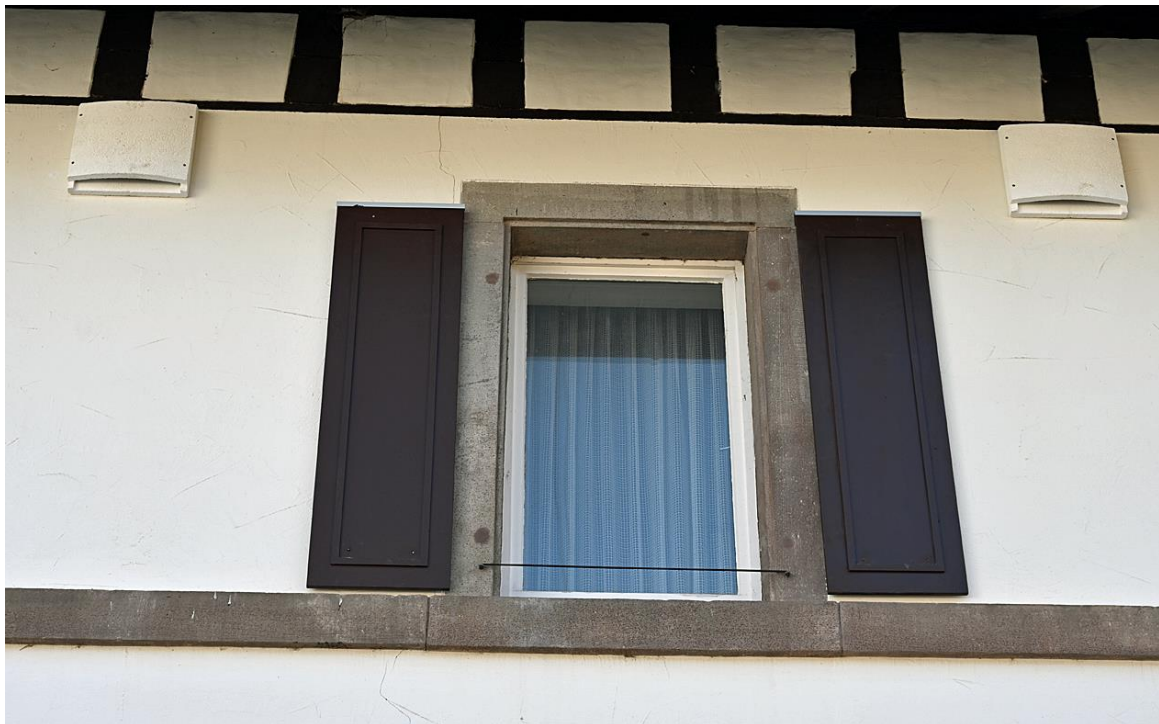
Abb. Anhang IA-1: Fest montierte Scheinfensterläden als Fledermausquartier (und zwei Fassadenflachkästen oberhalb).
