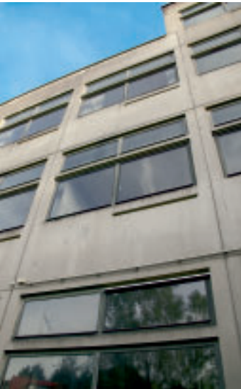
2 Progymnasium Furtwangen. Fassadendetail der im Betonwerk hergestellten Betonelemente mit Metallfensterrahmen und Belüftungsvorrichtungen.
